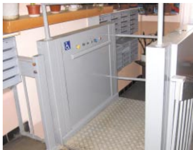
Подъемная платформа вертикального перемещения внутри подъезда дома 13 корпус 2 по ул.Новокосинской.
